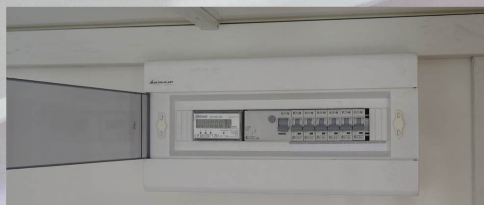
Instalacja elektryczna 230 V / 400 V
