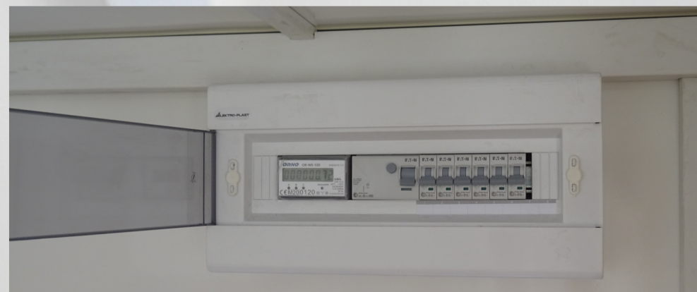
Instalacja elektryczna 230 V / 400 V
