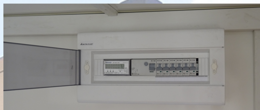
Instalacja elektryczna 230 V / 400 V
