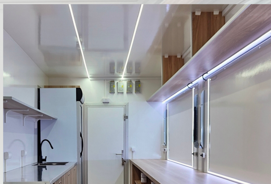
Instalacja elektryczna dopasowana do projektu
