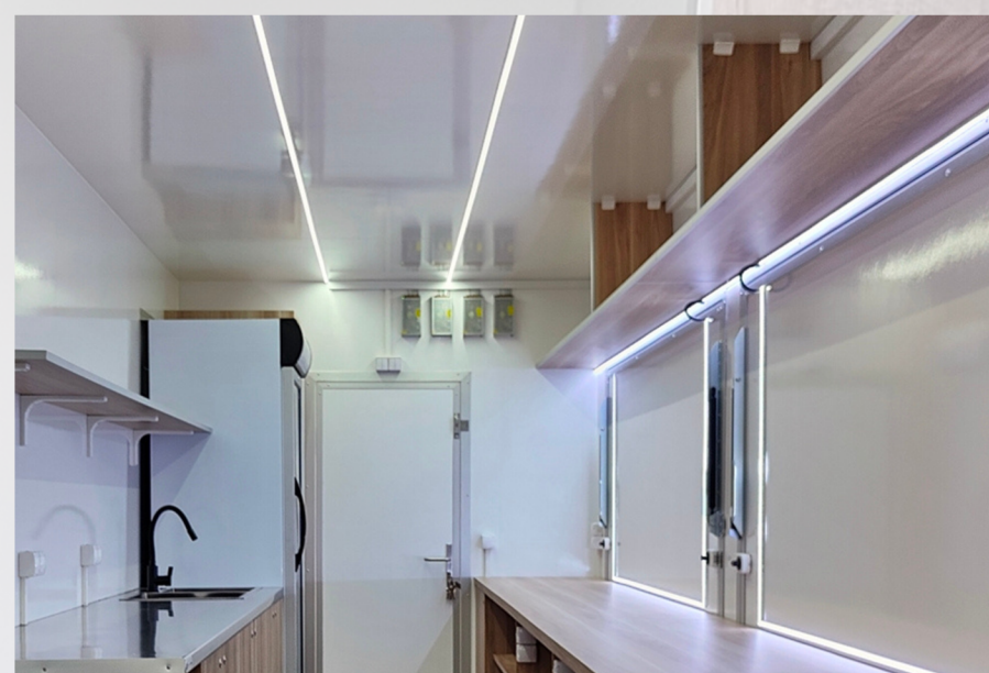
Instalacja elektryczna dopasowana do projektu
